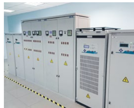
Оборудование ЩПТ 220 В, ЩПТ 27 В и зарядно-подзарядные устройства 220 В и 27 В
